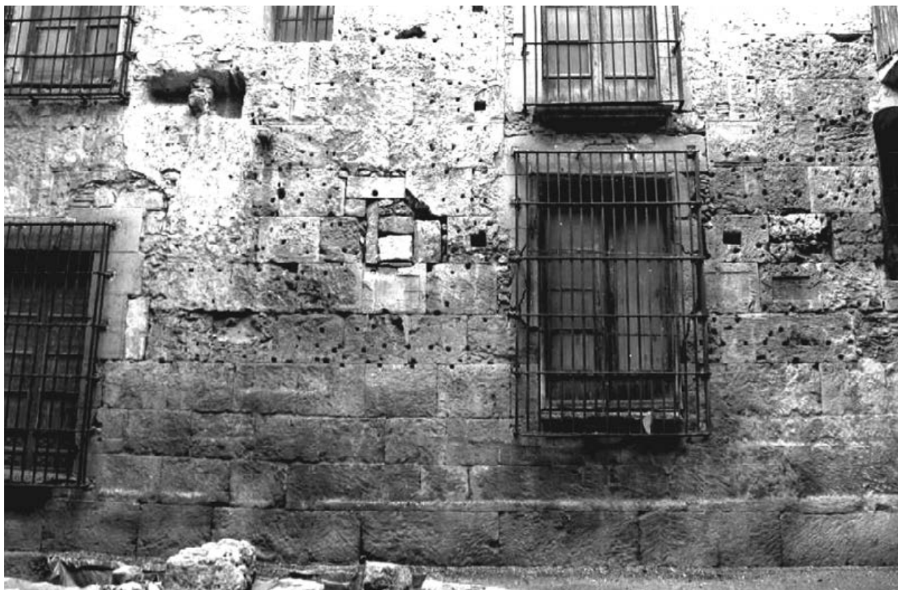
Fig. 62: Pared lateral del interior de la gran aula axial de época flavia 3 61, núm 23). El muro romano se ha conservado en altura y muestra los orificios de las grapas metálicas del revestimiento de mármol. Aparecen sólo a partir de una cierta altura. Ello implica que había un podio adosado a la pared del aula que debía sostener las columnas de la decoración.
