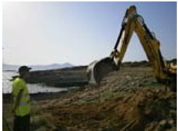
FOTO 12. Feines realitzades: control de la retroexcavadora durant l'eliminació de la terrera del sector sud-est del jaciment.
