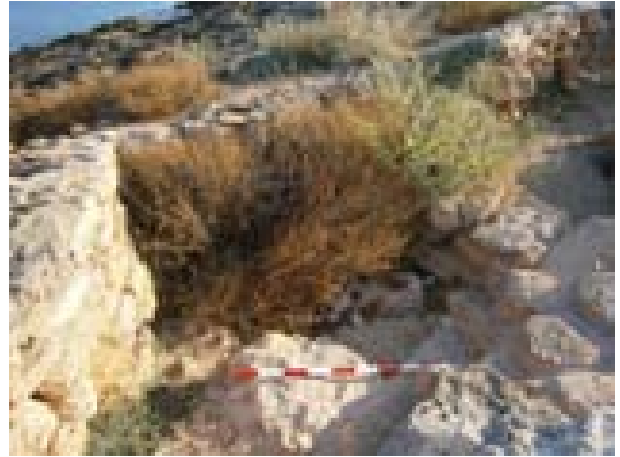
FOTO 2. Estat previ. S'observa el creixement de vegetació damunt les estructures.
