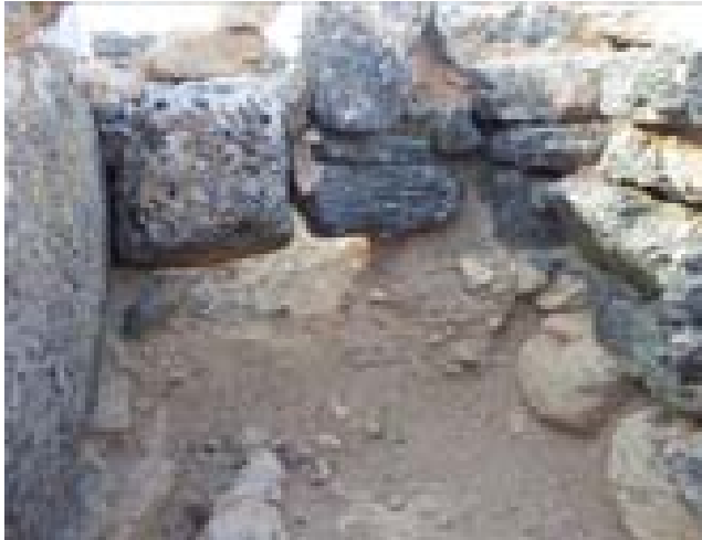
FOTO 17. Vista interior de T11, veiem la manca o total pèrdua de la fonamentació.
