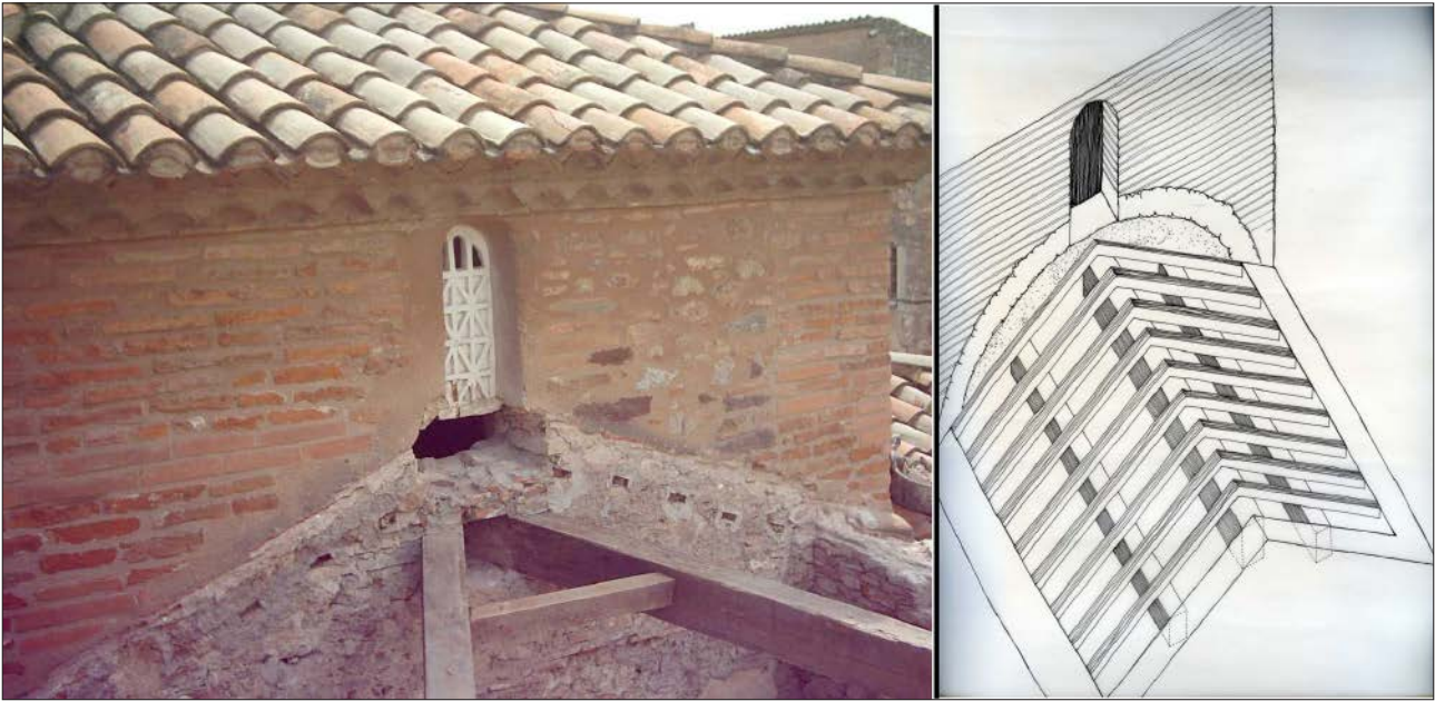
Figura 10. Izquierda, evidencias de la cubierta original durante el proceso de restauración (1980). Derecha, interpretación del sistema de cubierta de los brazos de la cruz griega (Archivo J. Ambrós - Museo de Terrassa).
