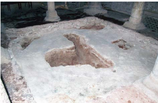
Figura 11. Niveles de cal extendidos durante el proceso constructivo en el centro del edificio y cimentaciones corridas de la columnata (archivo Museo de Terrassa).
