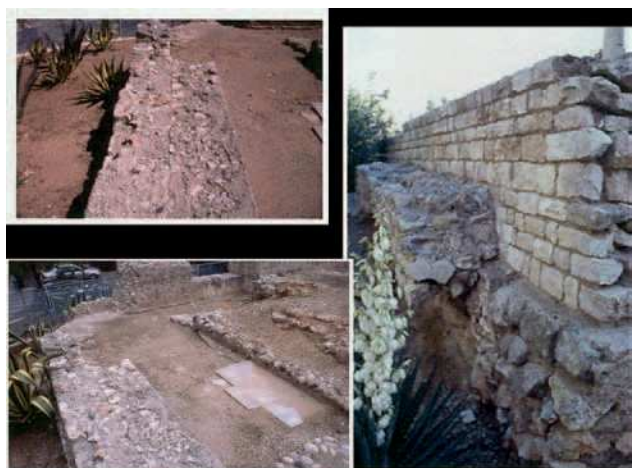
Fig. 20. Vista de los muros perimetrales de la basílica jurídica mostrando siempre el añadido de un segundo muro de refuerzo perimetral.
