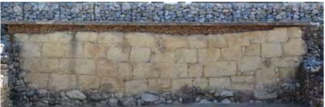
FIGURE 7. Le parement nord-sud de l'enceinte dans la partie centrale de l'oppidum, à la limite du secteur IX, dans son état restauré actuel.
