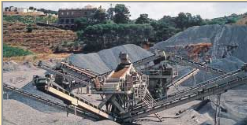
Planta de trituración y clasificación de Panasfalto en la mina Eugenia, procesando la escombrera en 1991. Foto: J. Abella.
