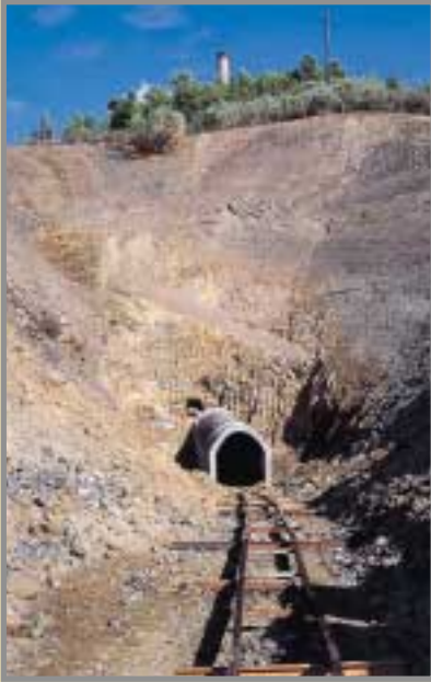
Estado, en octubre de 1998, de las obras de excavación de la salida de emergencia para el cale a la planta "Els Vells" de la mina Eugenia, desarrolladas por el Ayuntamiento de Bellmunt para las visitas turísticas a la mina. Foto: G. García.
