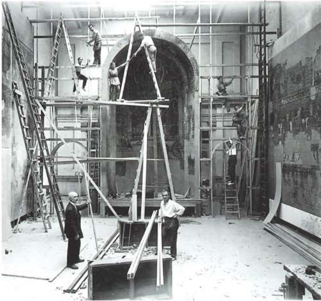
Palau de la Ciutadella. Treballs d'instal·lació de les pintures de Santa Maria de Taüll a la sala corresponent del Museu.
